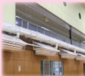
山幸アリーナ明和 GHP エアコン設備工事
