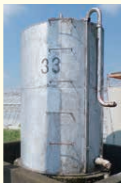
農業ハウス用燃料タンク
