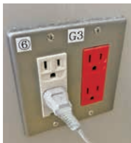
停電時でも使用可能なコンセント
