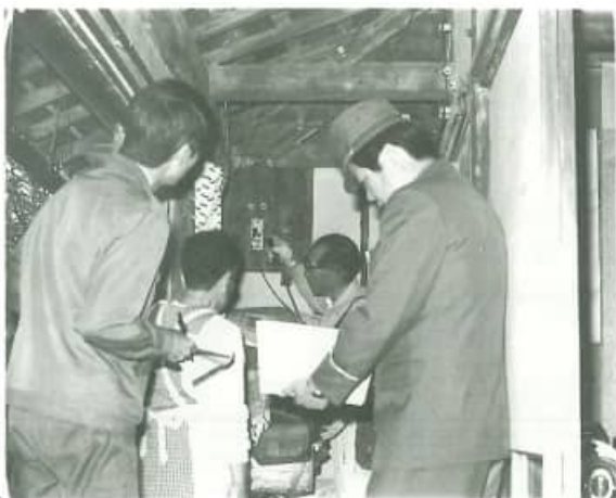
配線を点検する関係者
