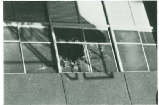
▼ガラスを壊された排水機場
