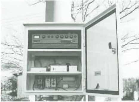
オフトーク通信接続装置ボックスの内部
