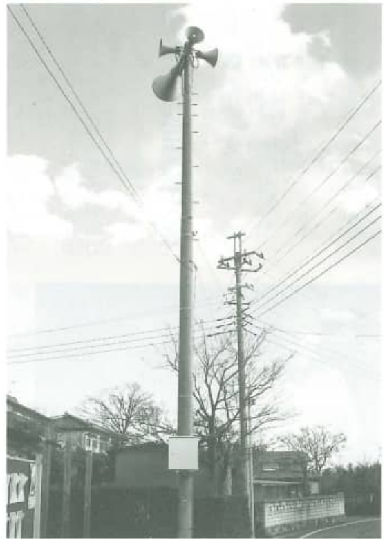
屋外放送塔とオフトーク通信接続装置ボックス
