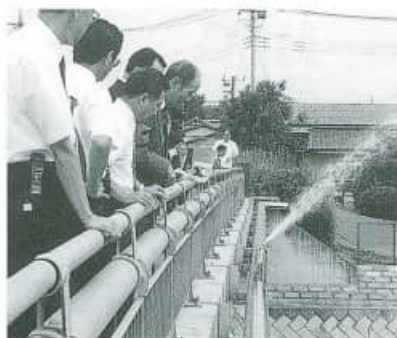
点検口から水が出るのを確認する関係者
