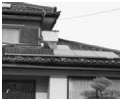
設置された住宅用太陽光発電システム
