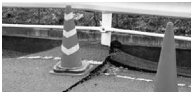
隆起した道路（矢島地区）
