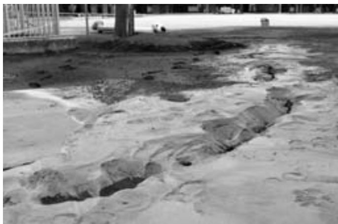
液状化現象で水や砂が噴出した、こども園庭（田島地区）
